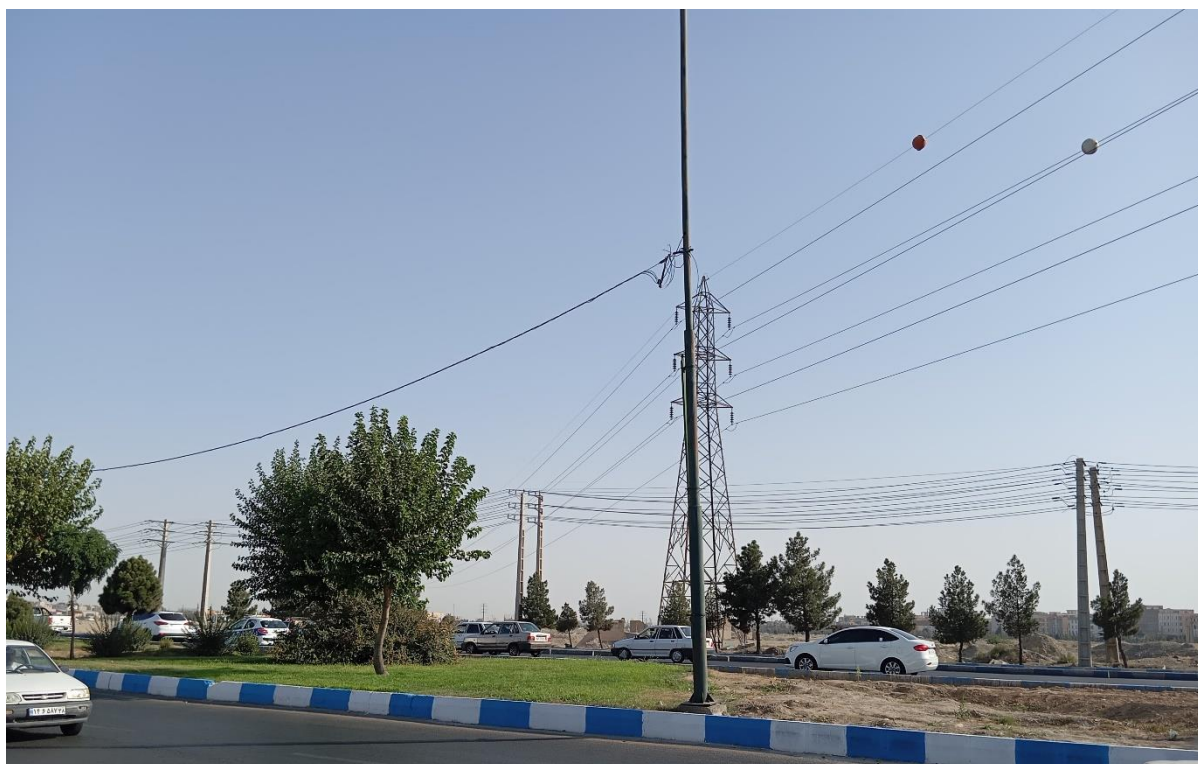
شکل ۱۰۰-۱ دکل های برق در مسیر مترو در بلوار ولایت
